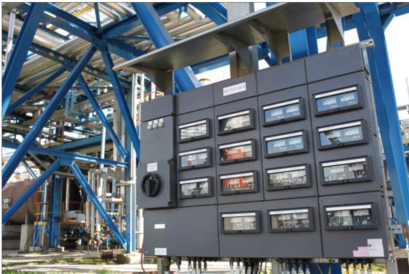
Fot. 3. Rozdzielnica lokalna zasilająca przewody grzejne na jednej z instalacji Programu 10+
