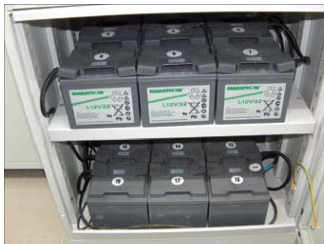
Rys. 5. Akumulatory baterii centralnej
